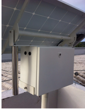
Figura 3: Estrutura principal do poste com o painel solar.
